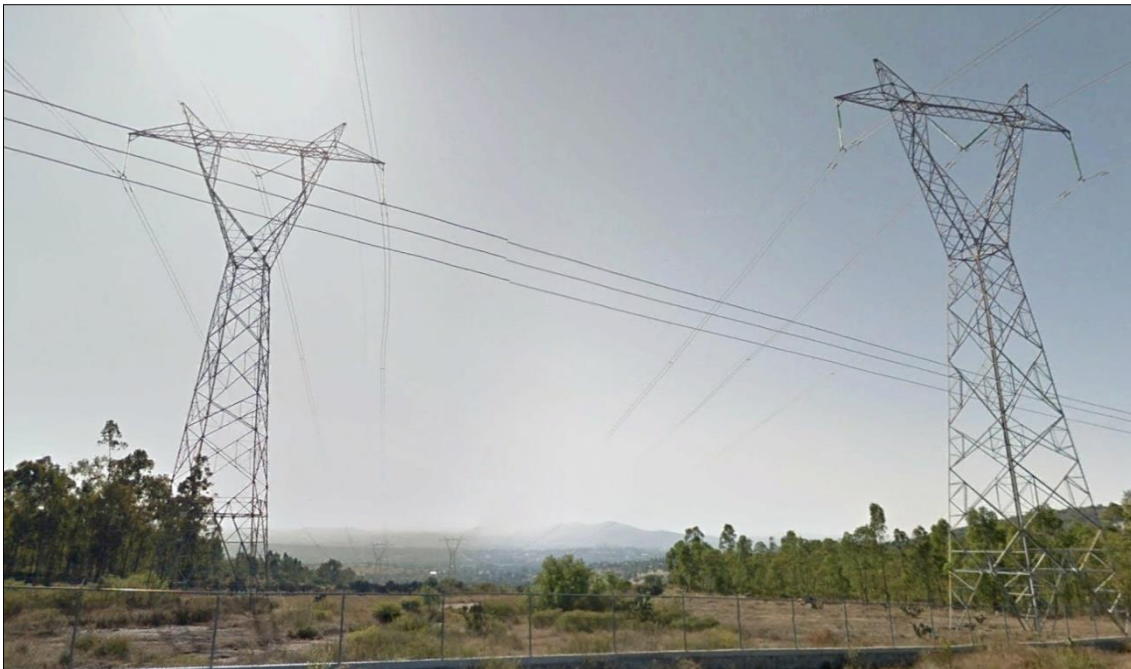
Figura 9.4.2.3. Torres de las dos líneas de transmisión del corredor Teotihuacán – Texcoco
